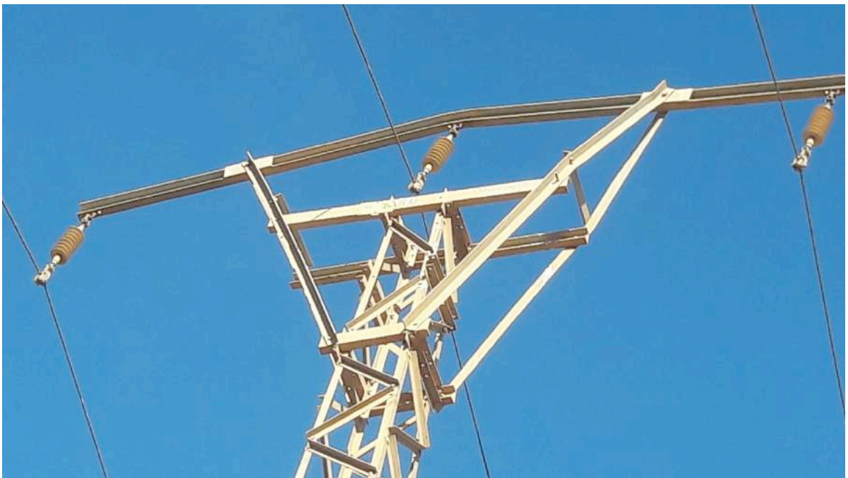
Photo 7. Poteau dangereux. Route de Plage Blanche, 29°01'22.93"N 10°24'19.31"W (photo Brahim Bakass)
